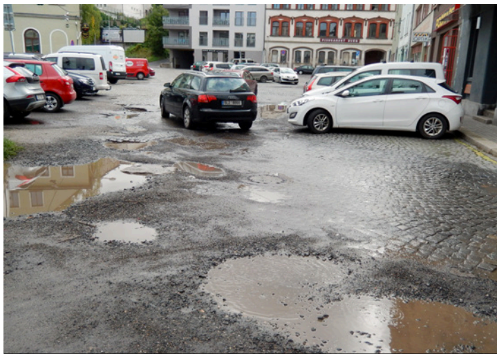
Stav povrchu Papírového náměstí a okolních komunikací je otrěsný Foto: Dana Lysáková
